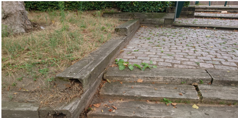
Achterstallig onderhoud aan paden en inrichting rondom het Paviljoen / Visserskot
