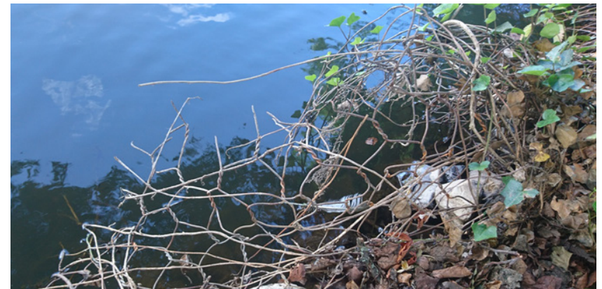
Het ijzerdraad rondom de steenkorven (dat 25 jaar geleden is aangebracht) aan de oevers van de vijvers is op veel plaatsen kapot en vormt een gevaar voor gebruikers.
